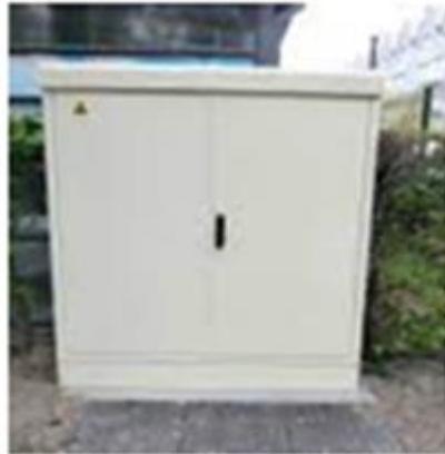
SOUS-REPARTITEUR OPTIQUE (SRO)
