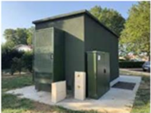
NŒUD RACCORDEMENT OPTIQUE (NRO)
